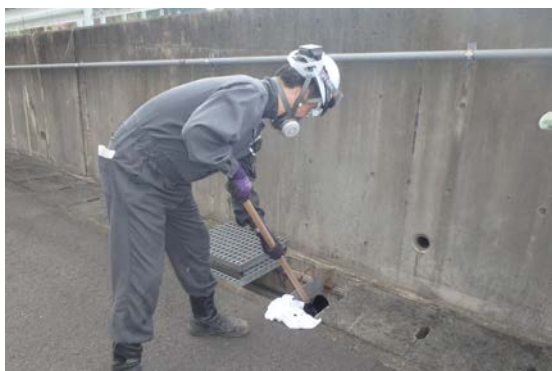
重油漏洩事故処置訓練（令和２年７月２１日）
